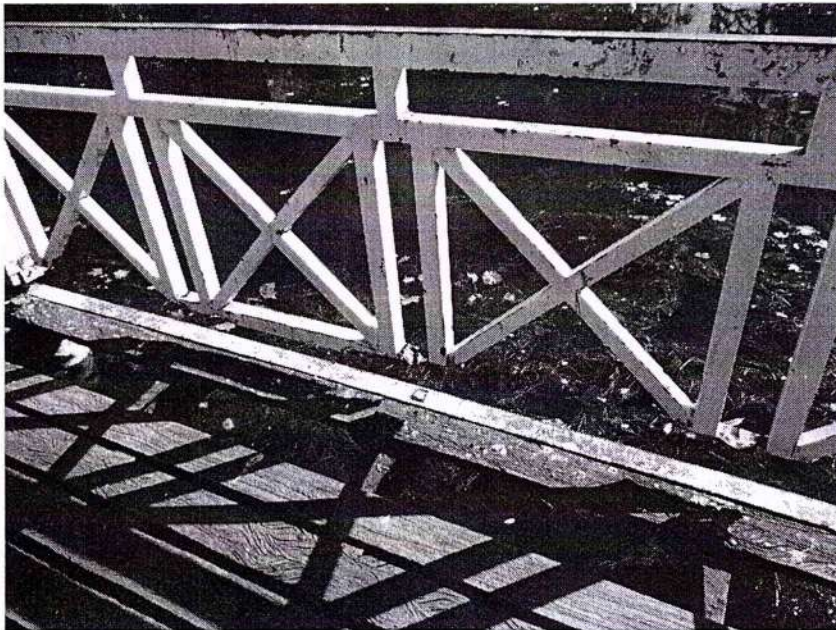
Fotografía N° 22- Glorieta Este. Barandas en mal estado y faltantes de piso.
