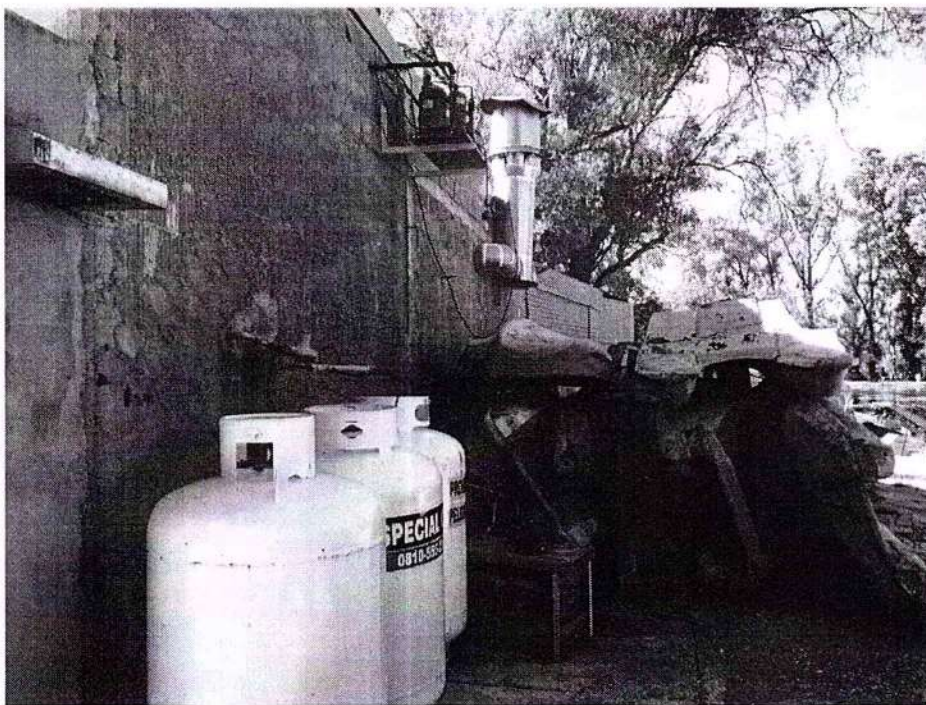
Fotografía N° 33- La presencia de elementos de instalaciones (tanques de gas), ventilaciones, motores y el depósito de elementos contribuyen a crear una zona desagradable e insegura para los visitantes del parque. No se ha tenido en cuenta la intervención estética de esta construcción, que debiera ser integral en todas sus fachadas.
